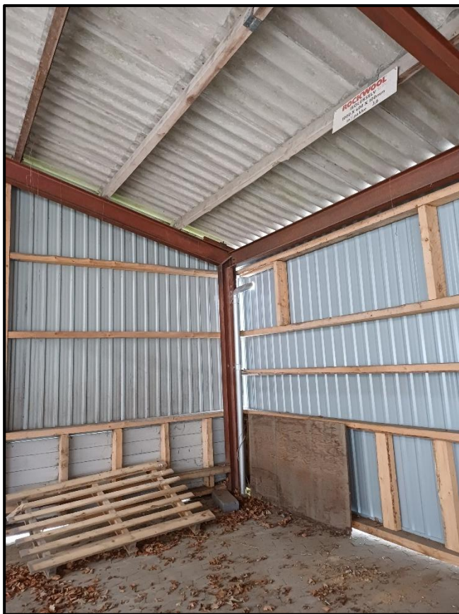
Figur 4.5: Huller i bygning 3. Foto: DMR A/S.
