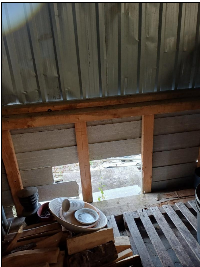
Figur 4.8: Hul i bygning 4. Foto: DMR A/S.
