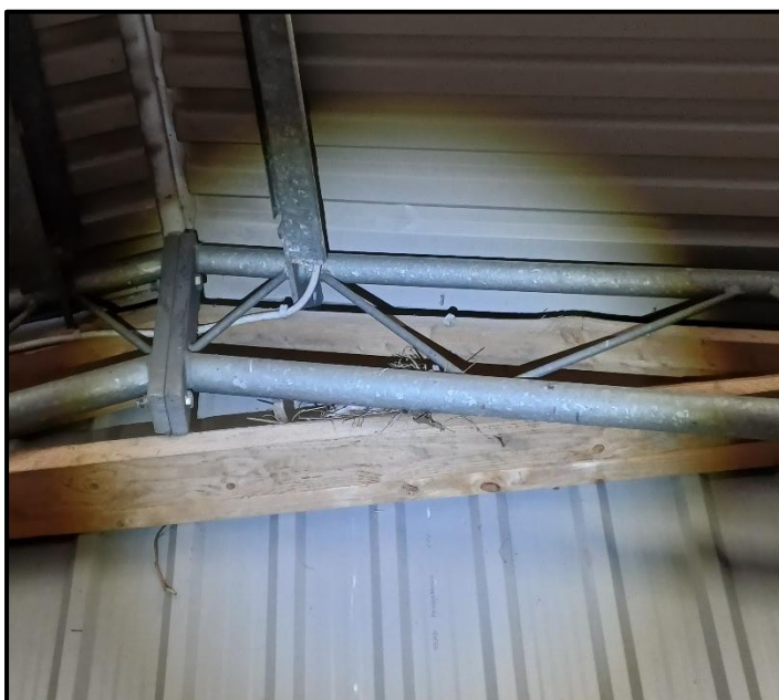
Figur 4.9: Inaktiv fuglereede ved bygning 4's nordlige endegavl. Foto: DMR A/S.
